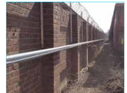
Boven- of ondergrondse circulatieleidingen rondom het terrein
