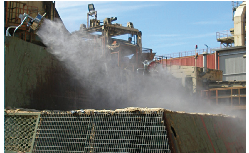
Exterior Wood Recycling Hopper - Gruppo Frati, Italy
